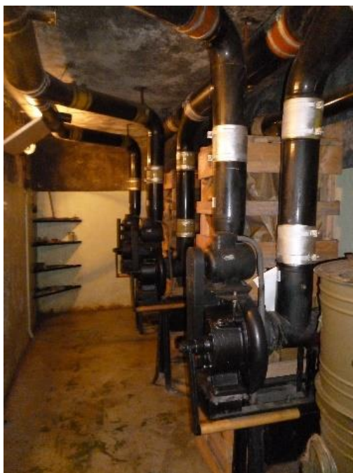
Obr. č. 17 Filtrventilační zařízení ve stálém úkrytu
